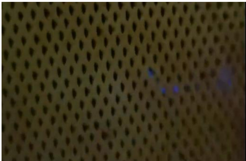
开关柜母排放电
