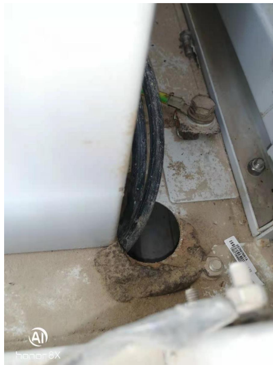
电缆孔洞未封堵
