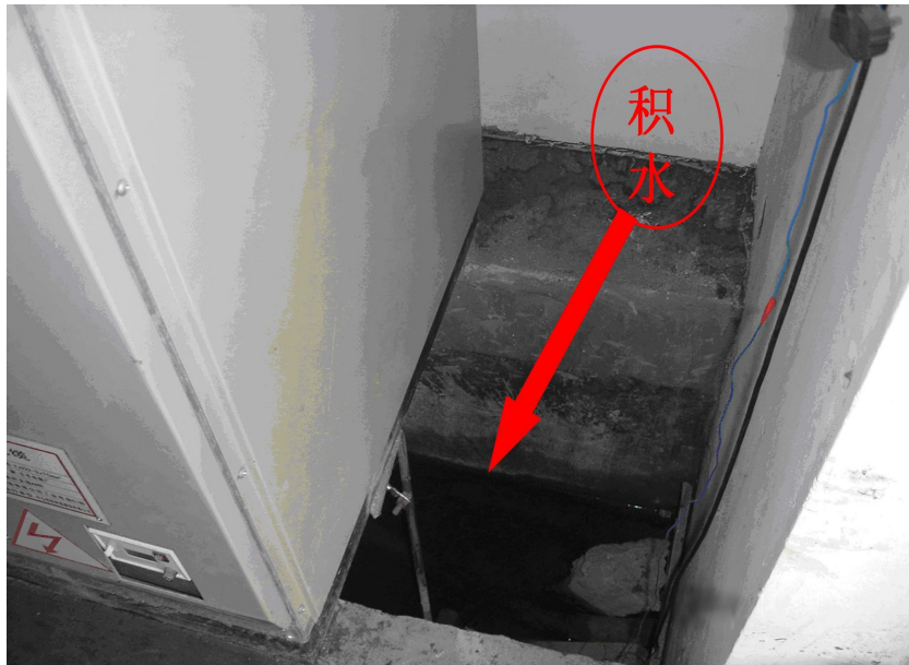
开关柜底部积水
