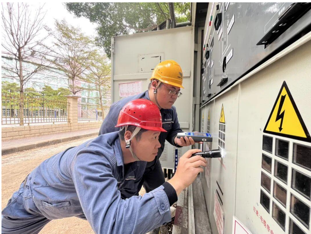
▲2月14日,南方电网广东梅州梅县供电局程江供电所工作人员对供电服务区域内配电柜开展“回南天”防潮检查,确保设备稳定运行。(肖晏鹏 摄)
