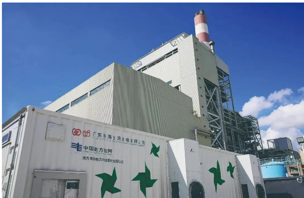
储能调频项目近景图
