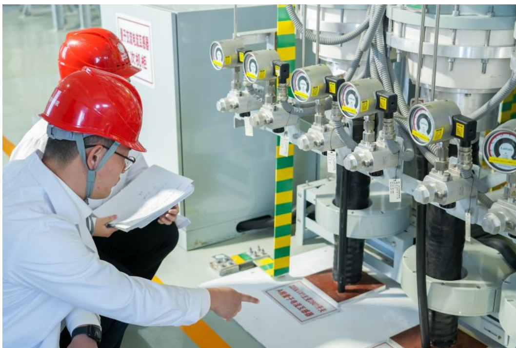
▲技术人员现场调试量子电流互感器
