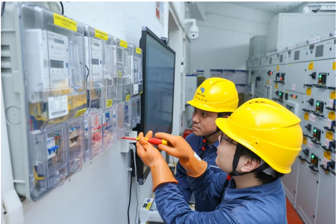
南方电网广东广州供电局党员突击队成员安装“电鸿”电表。（王港 摄）
