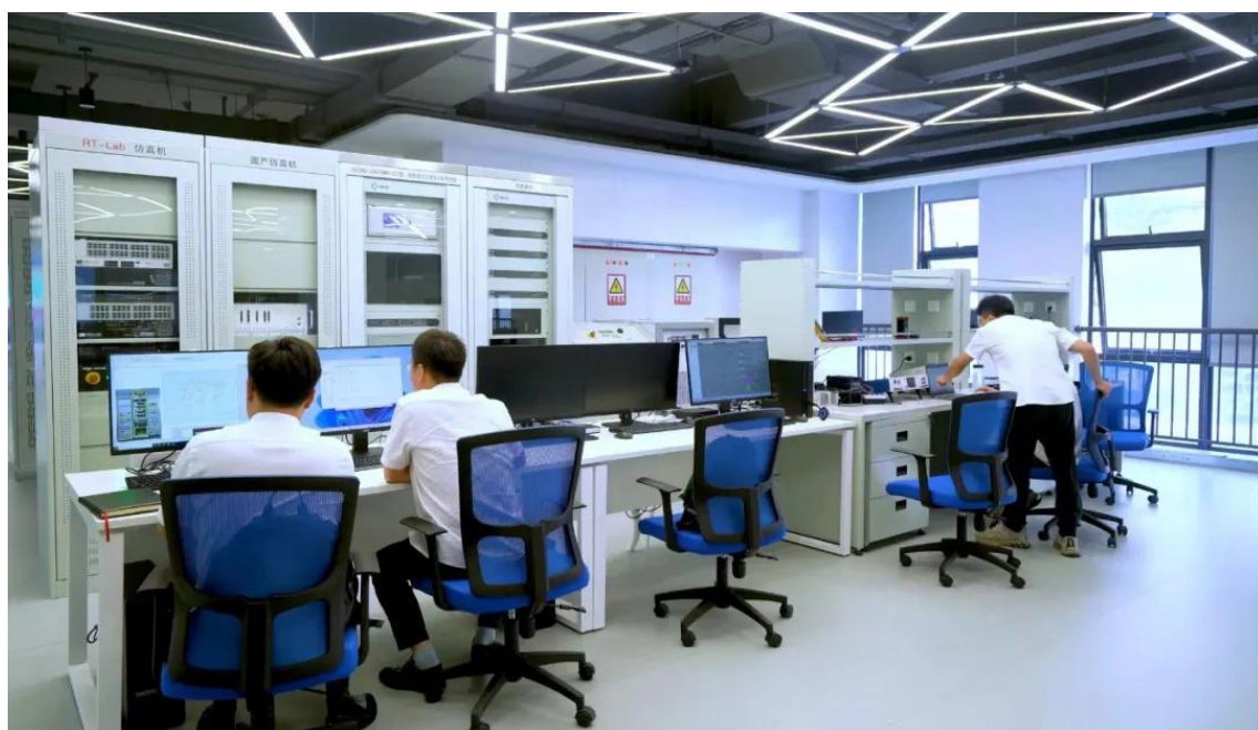
▲横琴数字零碳岛共享实验室设置了实体基础试验技术平台。
